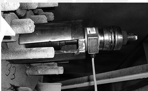
Rys. 7. Widok zainstalowanych elementów pomiarowych na głowicy zakotwienia czynnego
