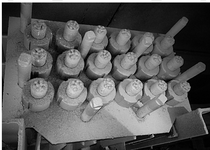
Rys. 3. Widok zakotwień czynnych przystosowanych do kontroli siły w poszczególnych kablach dźwigarów dachowych
