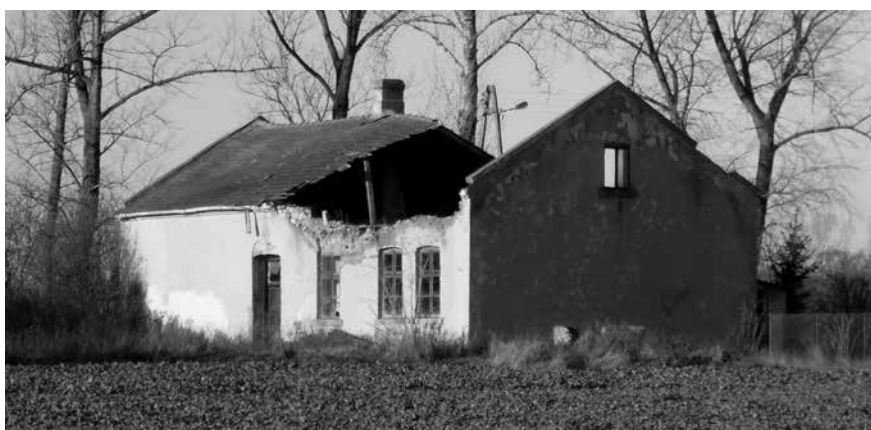
3. Budynek dawnej Szkoły Powszechnej w Wiesiołowie. Stan obecny Foto: Autor
