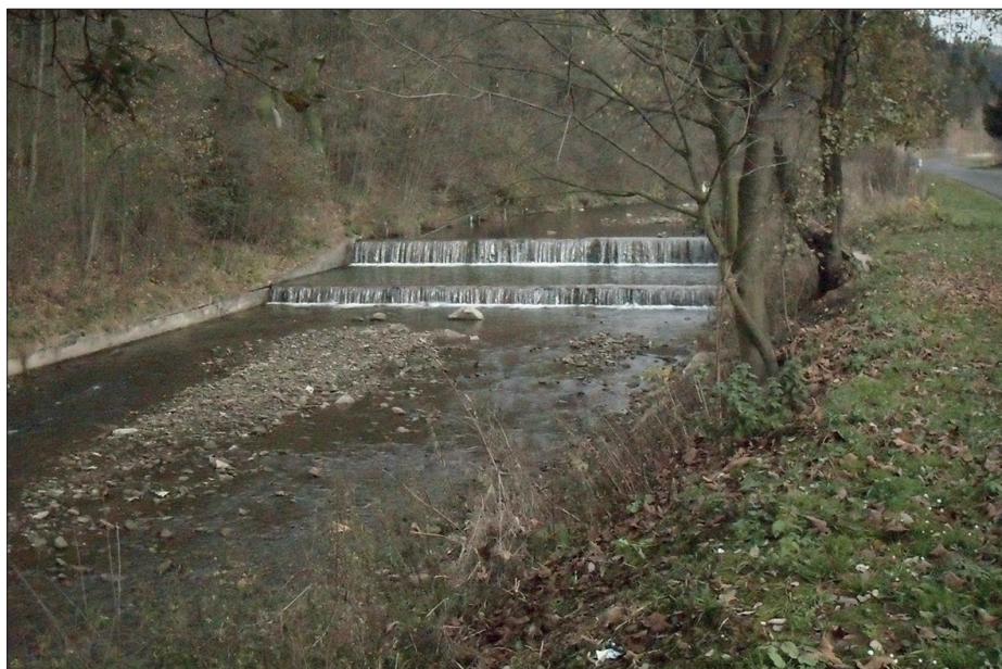
Fot. 5. Betonowe stopnie z towarzyszącymi im betonowymi umocnieniami brzegów (odcinek 3) Photo 5. Concrete drop structures with accompanying concrete bank reinforcements (section 3)
