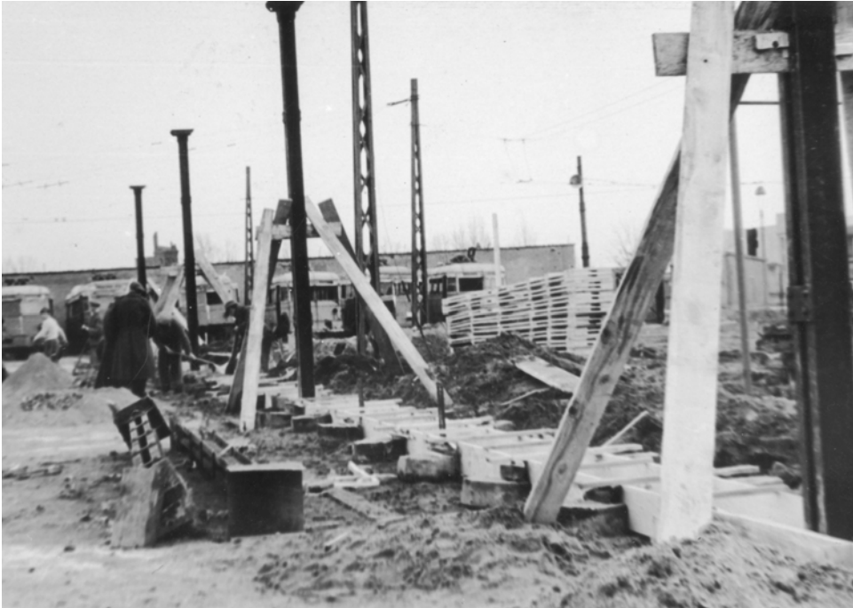
Ryc. 23. Budowa hali postojowej, o szkieletcie stalowym, o pojemności 30 trolejbusów. Na pierwszym planie zatapiane w beton słupy stalowe. Szalunek podpierany tzw. „kostką żerańską”. W tle osiem wraków radzieckich trolejbusów odstawionych do remontu (fot. NAC, sygn. 3-654.5).
