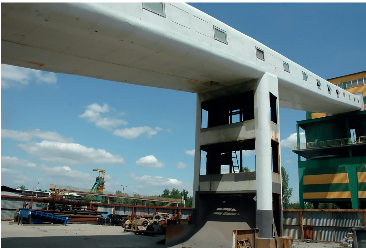
Fig. 2. The conveyor gallery – view from the south. On the right the ore haulage building, in the center the intermediate support Rys. 2. Galeria transportowa – widok od strony południowej. Po prawej budynek odstawy rudy, w środku podpora pośrednia
