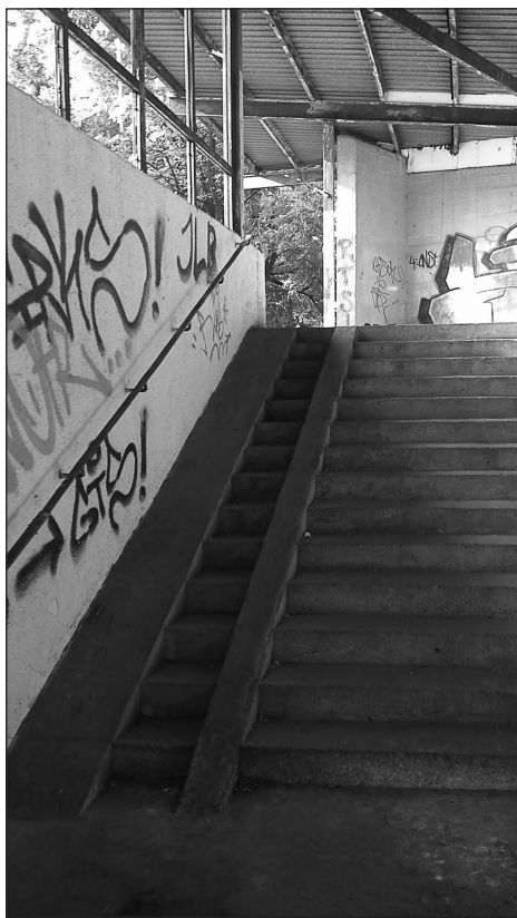
Fot. 3. Zniszczone zejście do przejścia podziemnego na dworcu Łódź Żabieniec (fot. P. Kosmowski)
