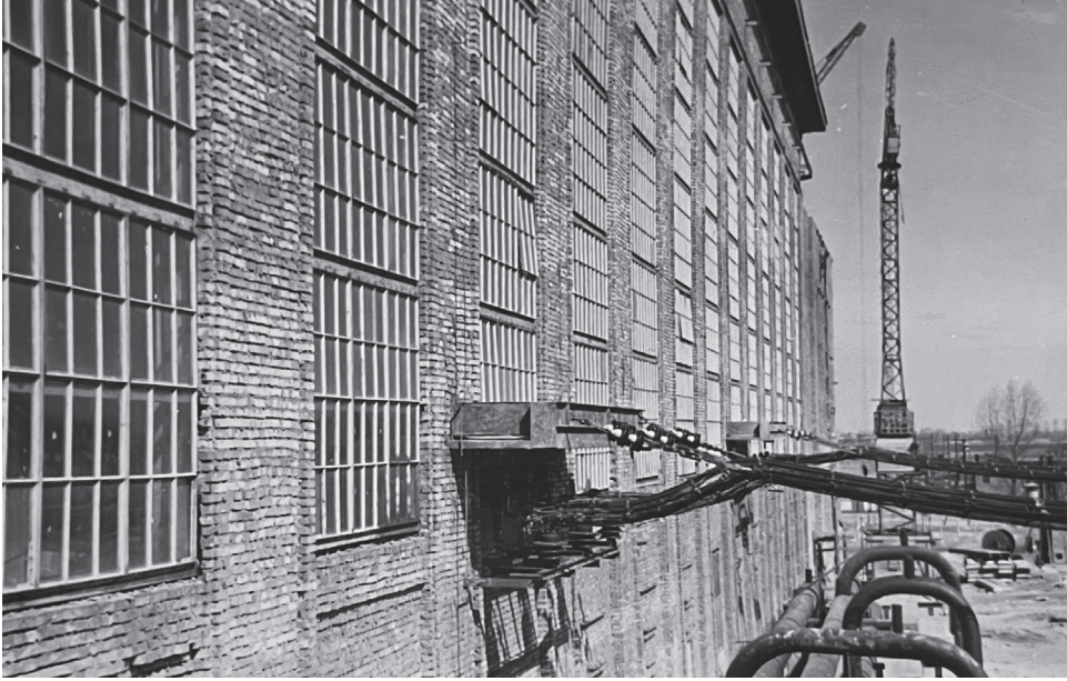
Ryc. 5. Ściana „A” hali głównej (źródło: Archiwum Państwowe w Warszawie, EC Żerań, 309, b.p.)
