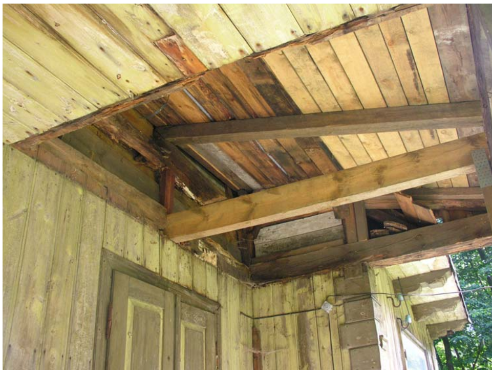
Ryc. 16. Bolimowski Park Krajobrazowy. Leśniczówka Kaczew (d. dworek myśliwski). Odsłonięta połać dachu pulpitowego ponad werandą podczas prac remontowych. Widoczna ścianka kolankowa (fot. Andrzej Cichy, 2007 r.)
