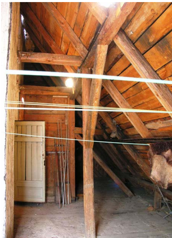
Ryc. 20. Leśniczówka Kaczew (d. dworek myśliwski). Widok przestrzeni strychowej z więźbą płatwiową dwustolcową i ścianką kolankową osadzoną w linii ścian wzdłużnych budynku. W głębi narożnik części mieszkalnej poddasza, ściana wzdłużna pokoju tradycyjnie wbudowana w ramę płatwiową (fot. Andrzej Cichy, 2007 r.)
