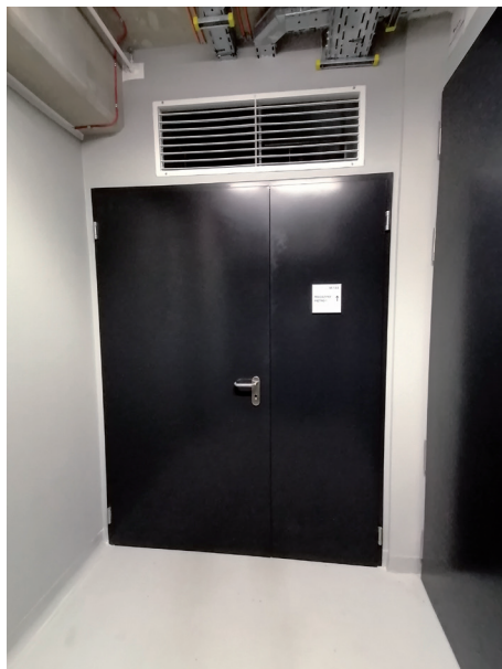
Il. 4. Drzwi do strefy magazynowej na jednym z pięter, fot. Barbara Berska
