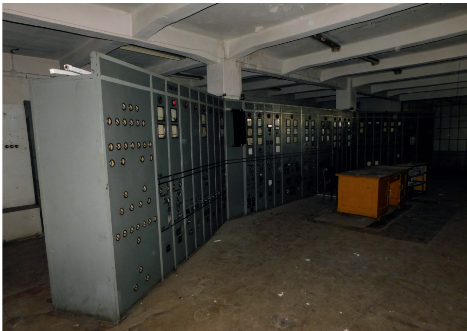
Ryc. 12. Nastawnia elektrowni (fot. B. Kozak)
