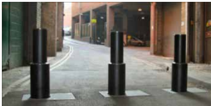
Zdjęcie 7. Bollardy automatyczne płytkiego montażu.
