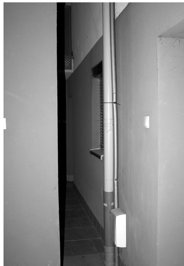
il. 3. Odległość okna od ściany windy wynosi 64 cm. (autor: Karolina Warzocha) / A distance between the window and the elevator's wall is 64 cm. (author: Karolina Warzocha)
