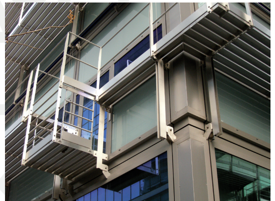
II. 4. Konstrukcja do obsługi rolet zewnętrznych (fot. B. Siedlecki)
