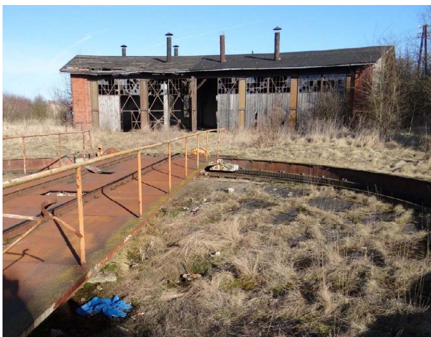
Ryc. 3. Niszczący budynek lokomotywowni na stacji węzłowej w Pruszczu (gm. Gostycyn).
